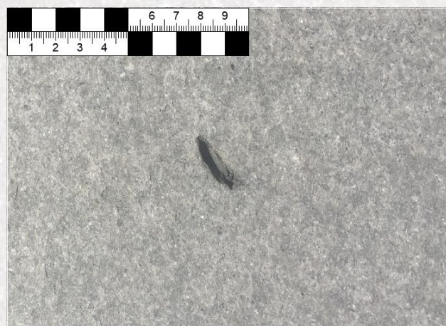
ausgewitterter Mergelinschluss (kann bei Bedarf fachmännisch reprofiliert werden)
